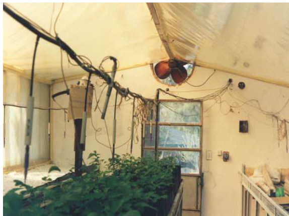
Fig.1a. Vista del interior de la cámara. Extractor
